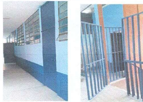
Foto 8: Puertas con mantenimiento
