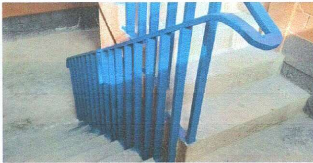
Foto 7: Baranda con mantenimiento
