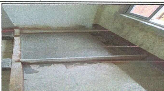
Foto 2: Caja de drenaje de pila de cocina
