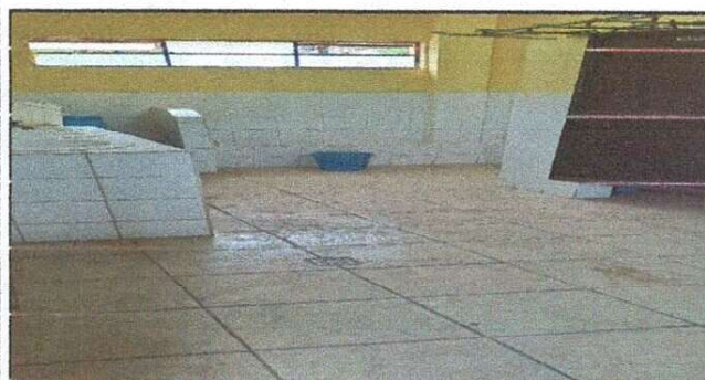
Foto 3: Fuga de agua en segundo nivel
