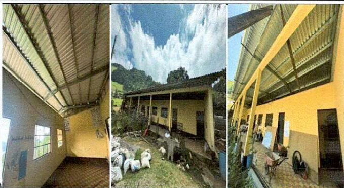
FOTO: 01-03: AREA DE MODULOS DE SALONES, CUBIERTA DE LAMINA ONDULADA, ESTRUCT. DE MADERA EN MAL ESTADO. SUSTI. POR LAMINA TROQUEL. CAL. 26 Y ESTRUCT. METALICA
