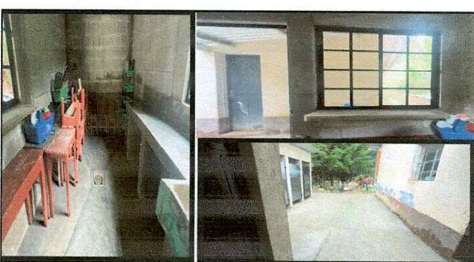
FOTO: 15-17: INTERIOR DE AREA DE COCINA, PAREDES Y TECHO EN MAL ESTADO, SE FUNDIO PISO DE CEMENTO ALIDADO EN AREA INTERNA CON SU REPOSADERA, TOP PARA PICAR Y AREA DE PILA
