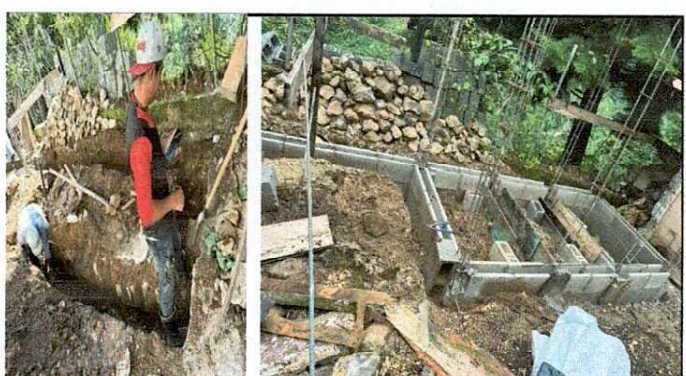
FOTO: 10 Y 11 SERVICIOS SANITARIOS EXISTENTES, SUSTITUYENDO LAS LETRINAS POR INODOROS LABABLES, Y CUBIERTA EN MAL ESTADO.
