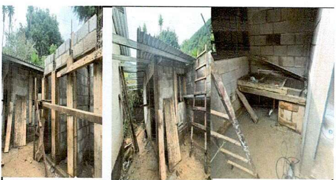
FOTO: 15, 16 Y 17: INTERIOR DE AREA DE COCINA, PAREDES Y TECHO EN MAL ESTADO, SE FUNDIRA PISO DE CEMENTO ALISADO EN AREA INTERNA Y AREA DE PILAS.
