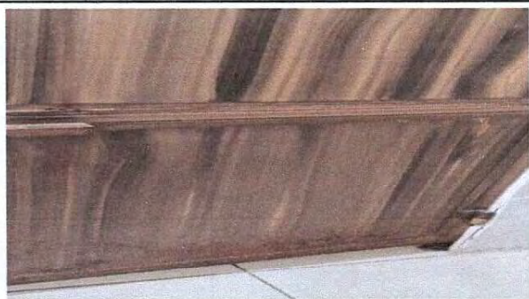
Foto 1: puertas de sanitarios oxidadas y picadas
