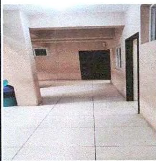
Foto1: Pintura en mal estado y sucia
