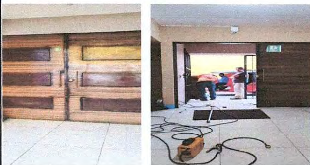
Foto 3: Porton y reja en mal estado mucha dificultad para abrir y quitar llave
