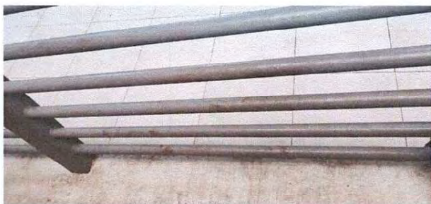
Foto 5: Baranda muy oxidada
