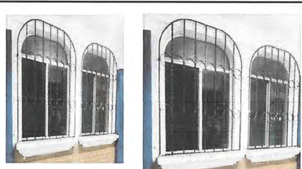
Foto 2: MODULO 2 VENTANAS: Mantenimiento de marcos de ventanas de aluminio mil finisish, limpieza e instalación de vidrios faltantes.
