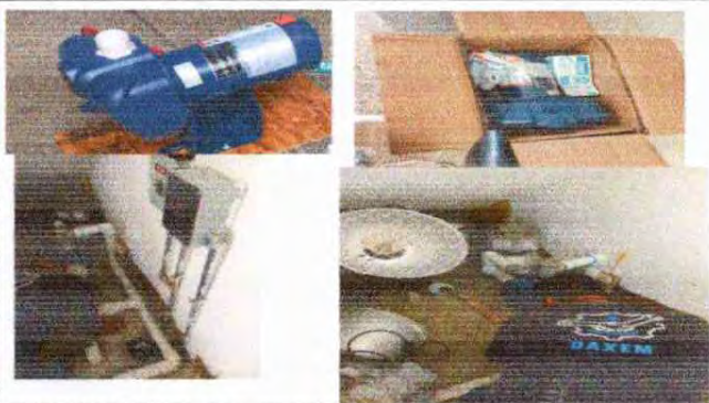
Foto1: Mantenimiento y reparación de cisterna y depósito de agua con cambio de bomba hidráulica por mal funcionamiento.
