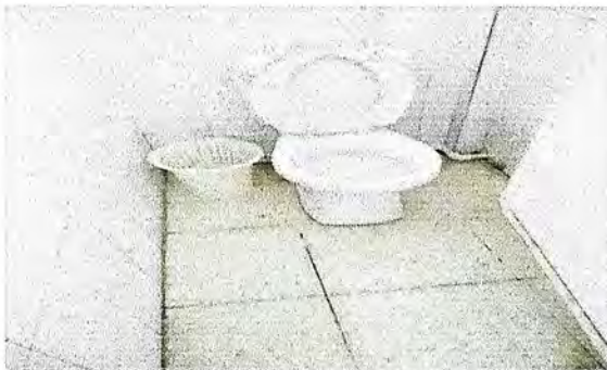
Foto 3: Cambio de accesorios (por deterioro) para cinco sanitarios en buen estado
