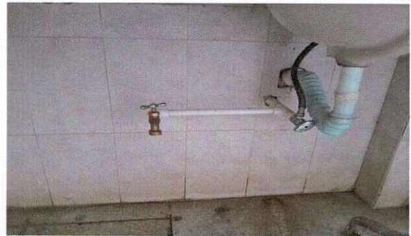
Foto 4: DISTRIBUCIÓN DE AGUA POTABLE
