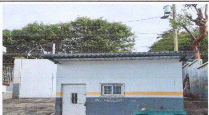
Foto 1 y 2: área de bodega cubierta de lamina de teja a sustituir por lamina nueva y costanera con medidas de 16 metros cuadrados
