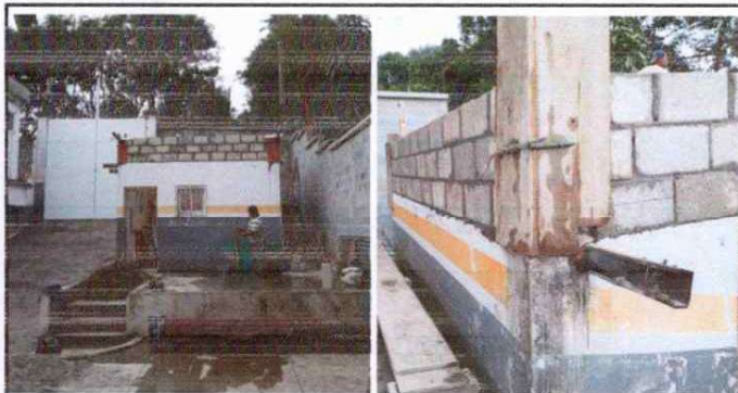
Foto 1 y 2: área de bodega cubierta de lamina de teja a sustituir por lamina nueva y costanera con medidas de 16 metros cuadrados
