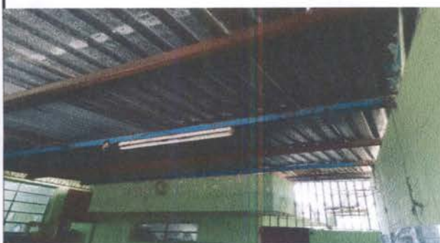
Foto 3: ESTRUCTURA DE TECHO- cocina y corredor de preprimaria, la estructura se encuentra oxidada y picada.
