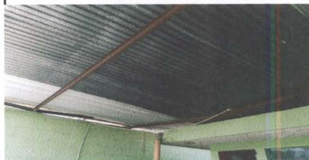
Foto 4: ESTRUCTURA DE TECHO- corredor de preparatoria, posee escasa estructura y deteriorada.
