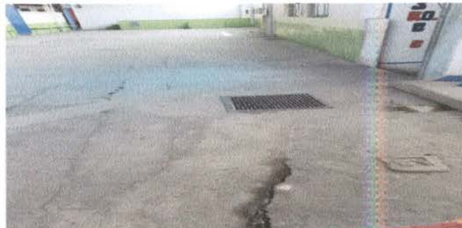
Foto 8: PISO- corredor principal, deterioro general, grietas, hundimientos, partes sin torta y agujeros en diferentes partes.
