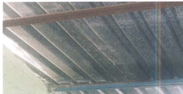
Foto 2: CUBIERTA DE LÁMINA- cocina, corredor de preparatoria, techo en mal estado, techo posee filtraciones.
