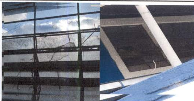
Foto 1: cambiar todos los vidrios que se encuentren quebrados, echar silicon donde falte, limpiar balcones y pintarlos
