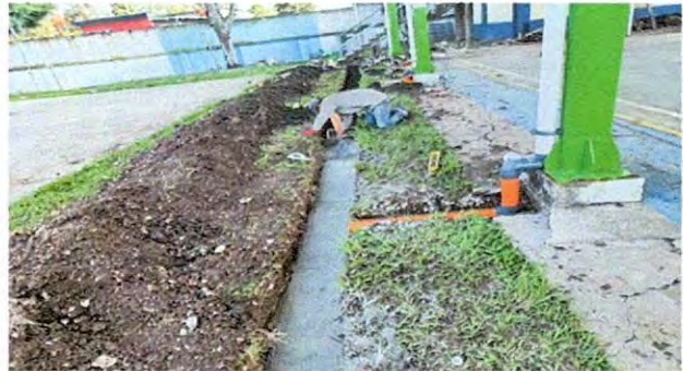
CANALAETA Y CONEXIÓN DE BAJADA
