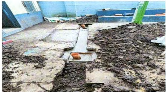
CAJAS Y CNALETAS
