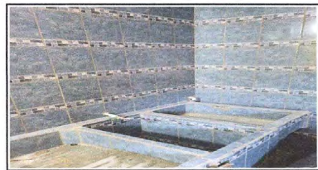
Foto: 1arreglo de lavado
