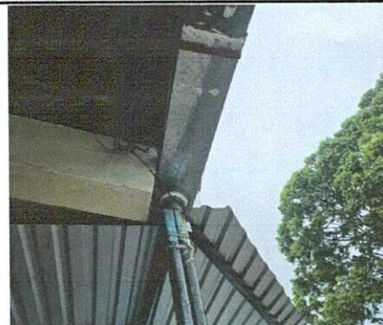
Foto 6: CAMBIO DE CANALES PODRIDOS
