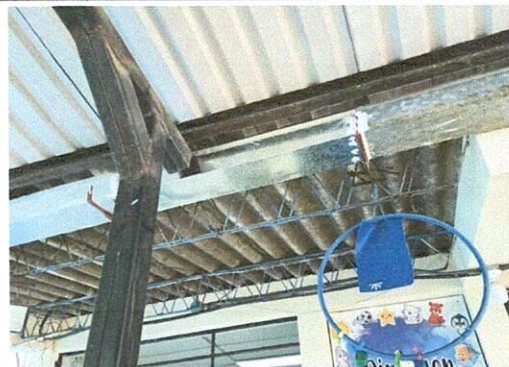
Foto 4: CAMBIO DE CANALES PODRIDOS.
