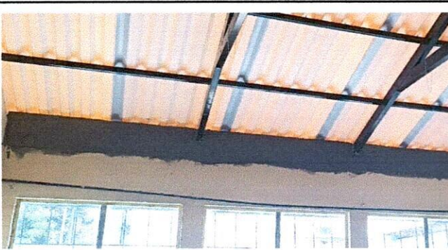
Foto 3: Iladas repelladas, de las aulas
