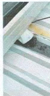
Foto 2: Prueba de salida de suciedad. Funcional sin dificultad.
