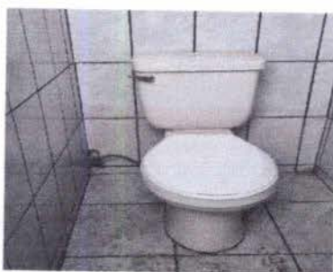
Foto 8: SERVICIOS SANITARIOS Y SUS ACCESORIOS
