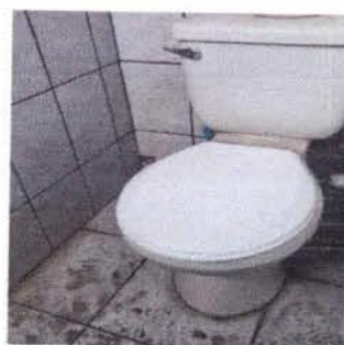
Foto 9: SERVICIOS SANITARIOS Y SUS ACCESORIOS
