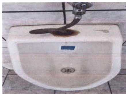
Foto 10: SERVICIOS SANITARIOS Y SUS ACCESORIOS
