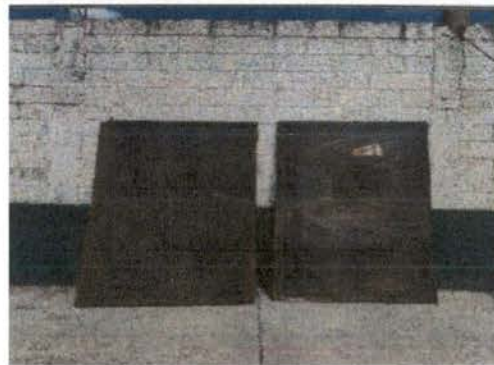
FOTO 8: MURO PERIMETRAL ABIERTA DE BOQUETE PARA PORTON
