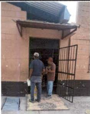
Foto1: Ausencia de techo en la puerta principal
