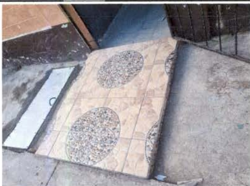
Foto 3: Ausencia de Banqueta en Ingreso
