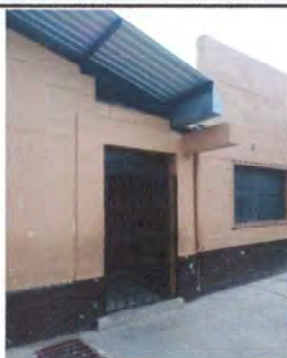
Foto 1: Ausencia de techo en la puerta principal
