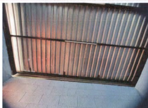
Foto 10 tapar las goteras en el techo
