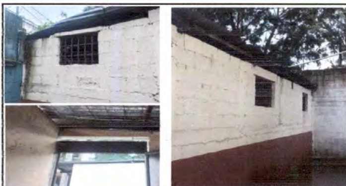
Foto 15: Cernido en paredes de salón cultural
