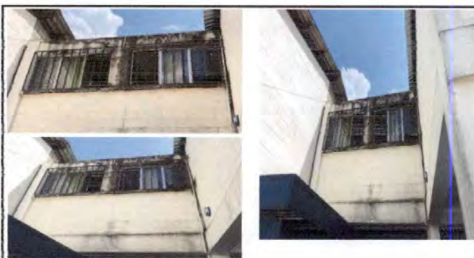
Foto 16: Filtraciones de Dirección
