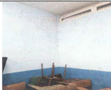
Foto 2: Filtración de agua en muros interiores.
