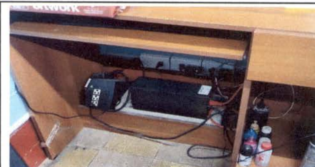
FOTO 24: TOMACORRIENTES/APAGADORES DE DIRECCION
