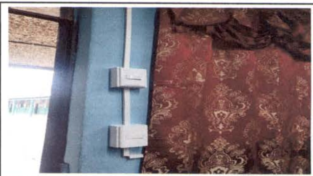
FOTO 22: TOMACORRIENTES/APAGADORES DE DIRECCION
