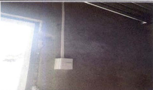
FOTO 21: TOMACORRIENTES/APAGADORES DE BODEGA (NO CUENTA CON APAGADORES)
