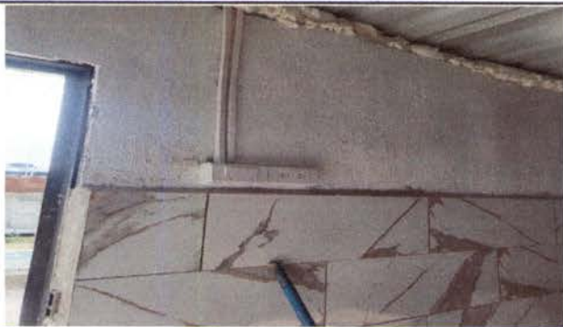
FOTO 19: TOMACORRIENTES/APAGADORES DE COCINA
