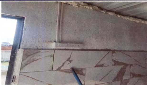
FOTO 19: TOMACORRIENTES/APAGADORES DE COCINA
