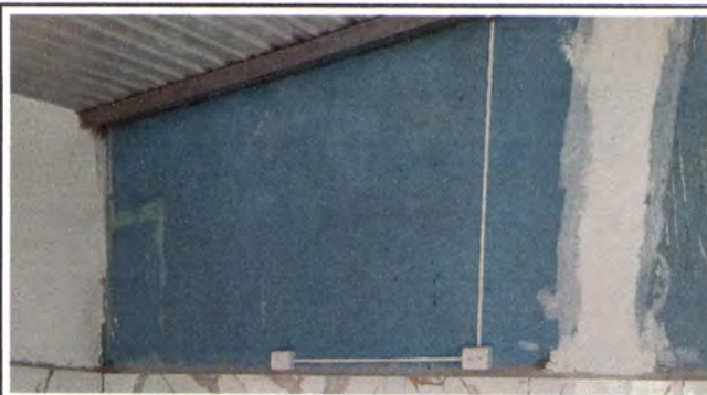
FOTO 20 : TOMACORRIENTES/APAGADORES DE COCINA
