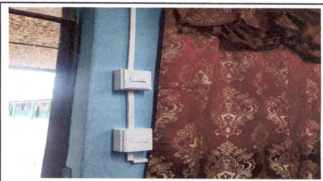
FOTO 22: TOMACORRIENTES/APAGADORES DE DIRECCION
