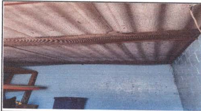
Foto 4: ESTRUCTURA DE METAL DE COCINA
