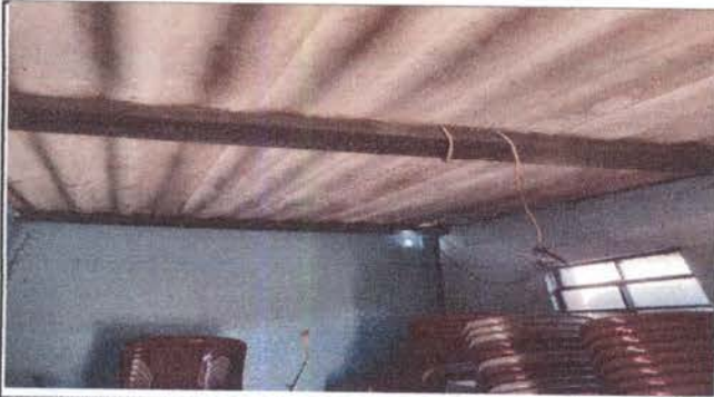
Foto 3: ESTRUCTURA DE METAL DE COCINA
