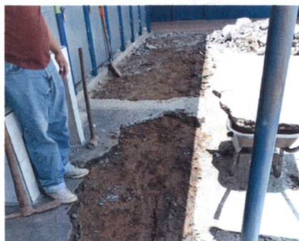
Foto 5: Eliminación de torta frente a sanitarios.
