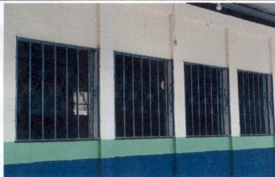
Foto 1: Las ventanas han sido retiradas.
