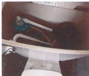
Foto 5: SERVICIOS SANITARIOS Y SUS ACCESORIOS
