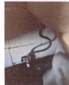
Foto 6: SERVICIOS SANITARIOS Y SUS ACCESORIOS
