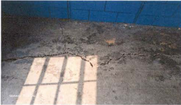
Foto 1: EL PISO SE ENCONTRABA TOTALMENTE QUEBRADO
