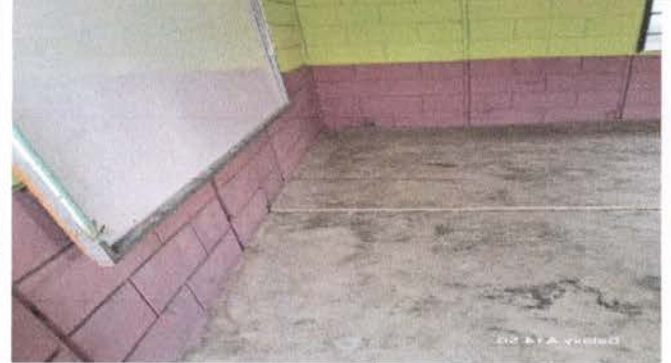
Foto 2: HUNDIMIENTO DEL PISO
