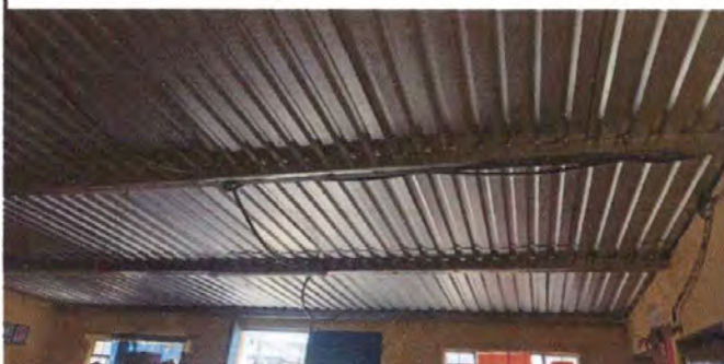
Foto 4: Sustitución de red electronica, lamparas led
