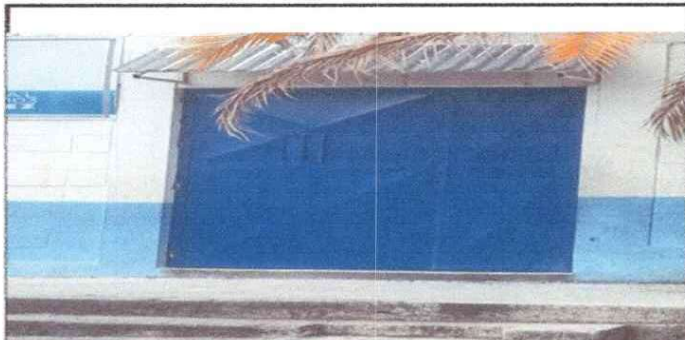
FOTO 2: PESTAÑA PARA PROTECCIÓN DEL PORTÓN
