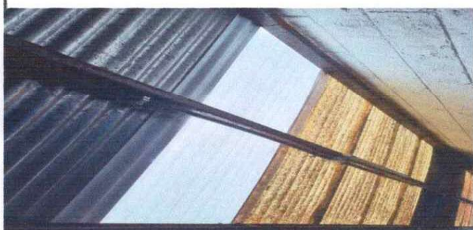
Foto 15: LAMINA DE PASILLO
