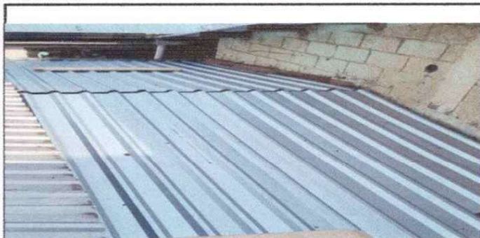
Foto 1: TECHO BAÑO DE MAESTROS
