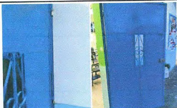
Foto 21: Puertas de aulas.
