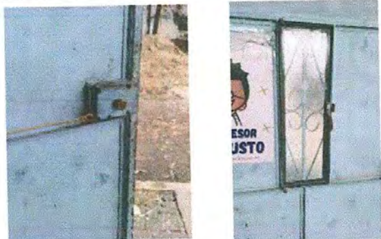
Foto 9: Chapas y ventanas de puertas de aulas.
