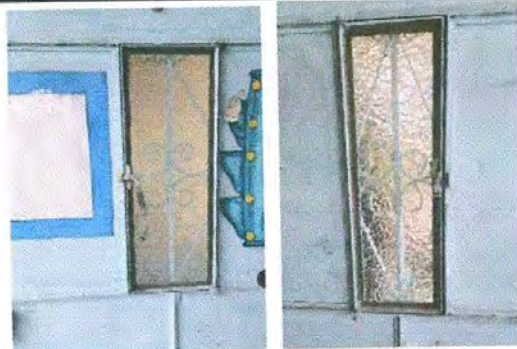
Foto 8: Ventanas de puertas de aulas.
