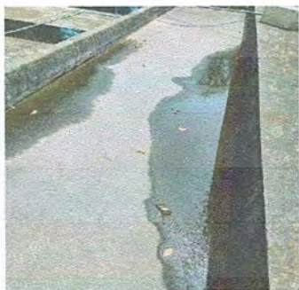
Foto 1: Empozamiento de agua en lasas
