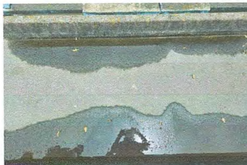
Foto 6: Empozamiento de agua en lasas
