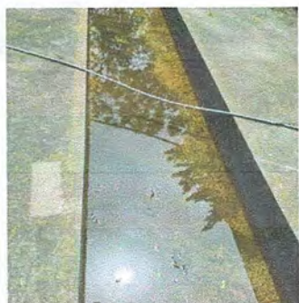
Foto 3: Empozamiento de agua en lasas
