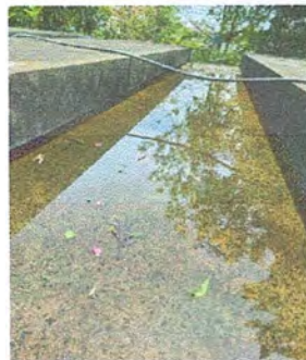
Foto 4: Empozamiento de agua en lasas
