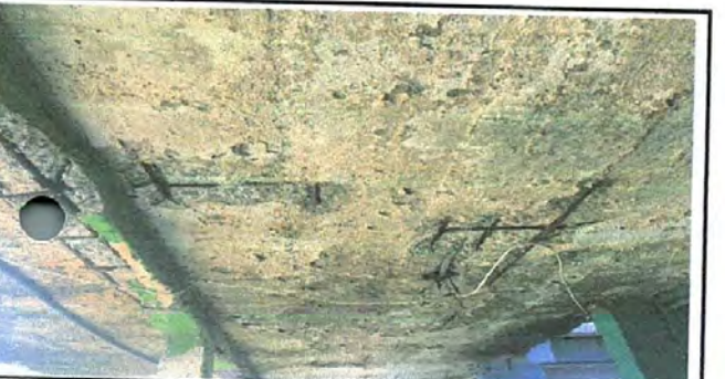
Foto: LOSA DAÑADA DE CORREDOR-PASILLO
