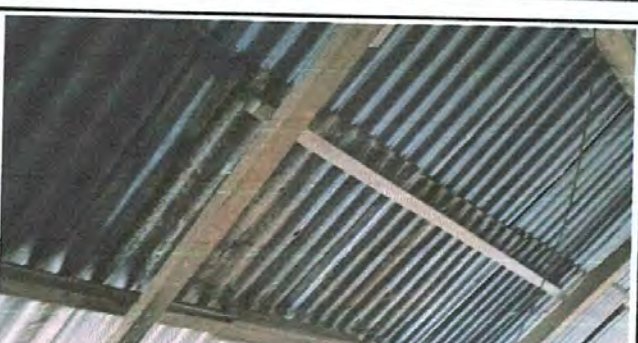
Foto: LÁMINAS Y MADERA DAÑADAS MÓDULO BODEGA-GUARDIANIA
