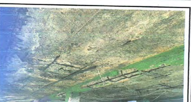
Foto: LOSA DAÑADA CORREDOR - PASILLO
