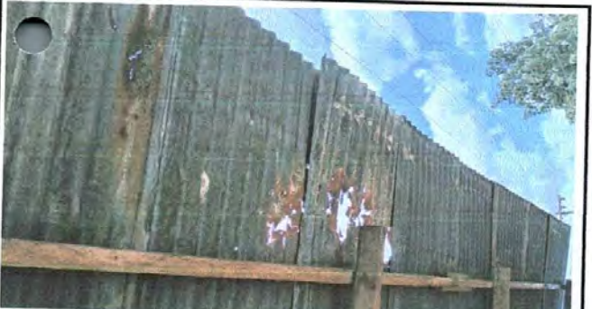
Foto: LÁMINAS DAÑADAS MÓDULO BODEGA-GUARDIANIA
