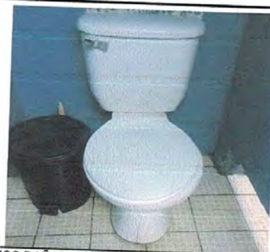
Foto: SANITARIOS DAÑADOS
