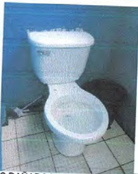
Foto: SANITARIOS DAÑADOS
