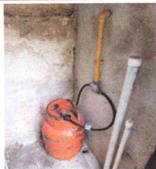
Foto 3: Tubería de gas
