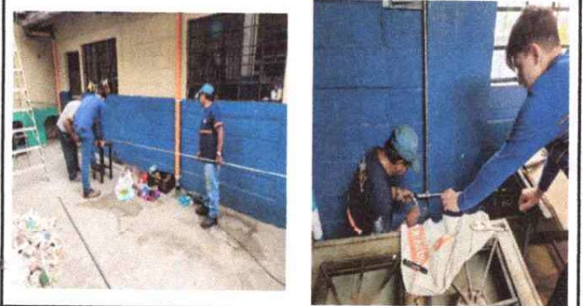
Foto 4: Tubería de gas
