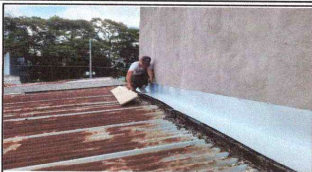
Foto1: Flashing, bota aguas
