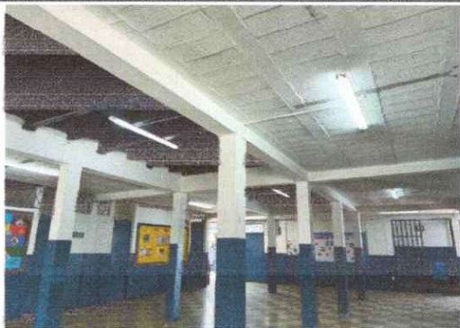
Foto 1: ILUMINACION DE PASILLO PRIMER NIVEL
