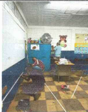
Foto 2: PROTECCION DE CABLEADO ELECTRICO AULAS PRMER NIVEL
