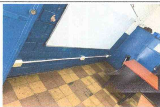
Foto 6: Proteccion de cables del sistema electrico en todas las aulas de primer y segundo nivel
