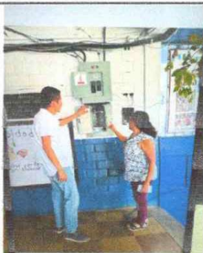
Foto1: Cambo de caja para unificar carga electrica
