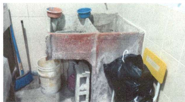
Foto 4: EN ESTA PARTE SE MUESTRA LA PILA QUEBRADA LA CUAL SE REALIZARA EL CAMBIO POR OTRA NUEVA
