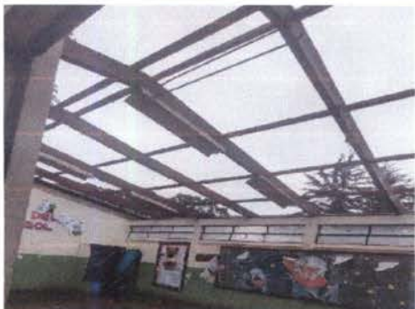
Foto1: Aula de segundo primaria ya sin techo de duralita
