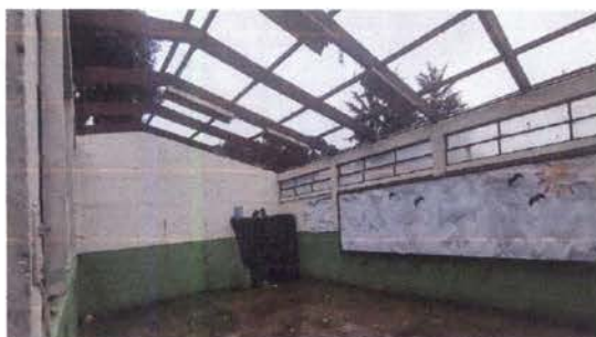
Foto 3: Aula de tercero primaria ya sin techo de duralita
