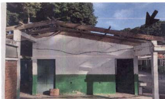
Foto 3: Madera en mal estado
