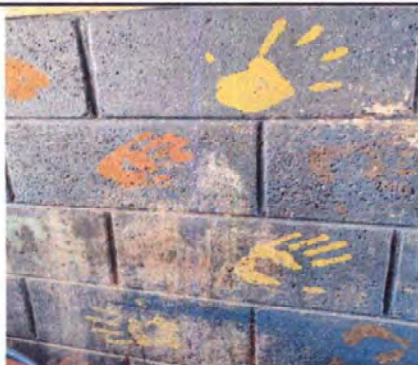
Foto 7: Cocina, muros interiores presentan deterioro en pintura.
