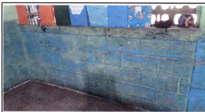
Foto 4: Paredes de aulas con pintura deteriorada.
