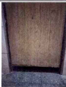
Foto 11: Puertas de baños de niños deterioradas
