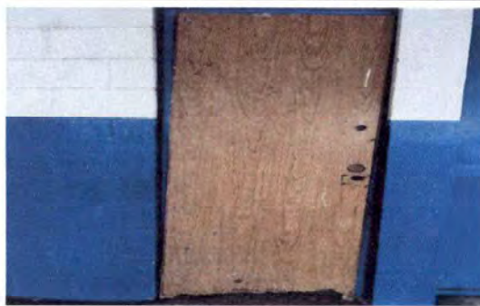
Foto 12: Puerta deteriorada en sanitarios de niños
