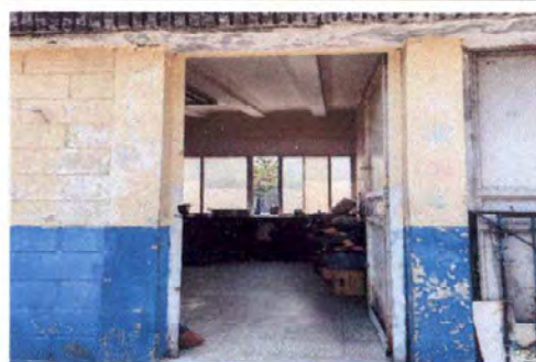
Foto 6: La pintura de la cocina está deteriorada.
