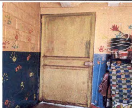
Foto 10: Puerta en cocina presenta óxido y deterioro.
