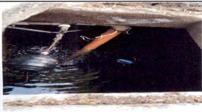
Foto 1: Cisterna deteriorada por falta de mantenimiento.
