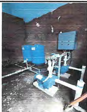
SISTEMA DE CISTERNAS FUNCIONANDO AL 100%
