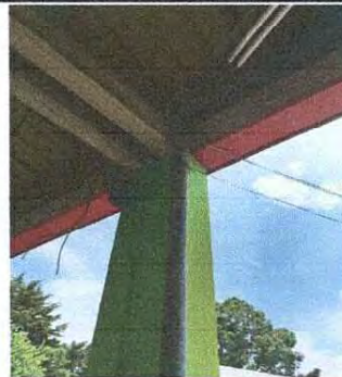
Foto 4: bajadas de aguas tapadas
