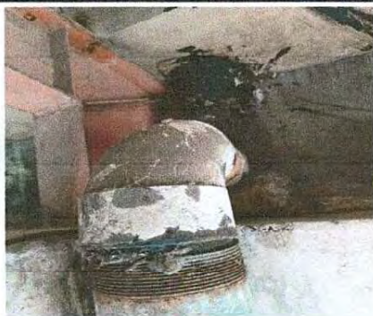
Foto 3: codos viejos de bajadas de agua
