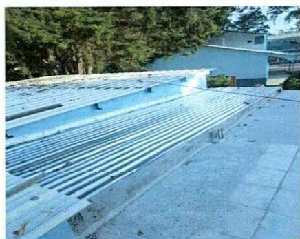
Foto 3: Sustitución de lámina y cargadores, anexo de la cocina, filtración de agua por deterioro de los cargadores y toques de lámina
