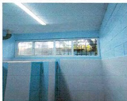
Foto 6: Sustrucción de ventana interior del servicio sanitario de varones, marco dañado, vidrios no abren, marco vencido
