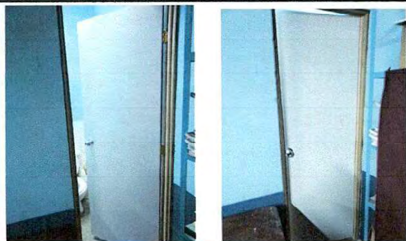
Foto 1: Sustitución de puerta de interior, biblioteca, dañada en la parte de abajo, vencida de las bisagras
