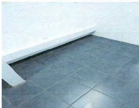
Foto 1: Sustrucción de piso servicio sanitario varones, dañado por el orin, filtración del orinal, caída de agua, daño llave de agua de sanitarios
