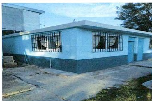
Foto 4: Sustitución de ventana, por deterioro del marco, las paletas de vidrio estan flojas, no se puede abrir, colocación de balcón
