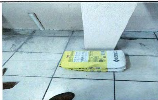
Foto 6. Sustitución de piso de la cocina, por deterioro se ha ido parchando con cuadros de otros colores
