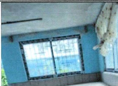
Foto 1: Saneamiento de cocina por salitre, en las paredes, por filtración de agua, de la terraza
