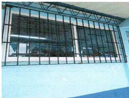
Foto 2: Sustrucción de ventana y balcón en oficina de Dirección, marco de ventana quebrado, vidrios no se pueden abrir por el oxido del metal
