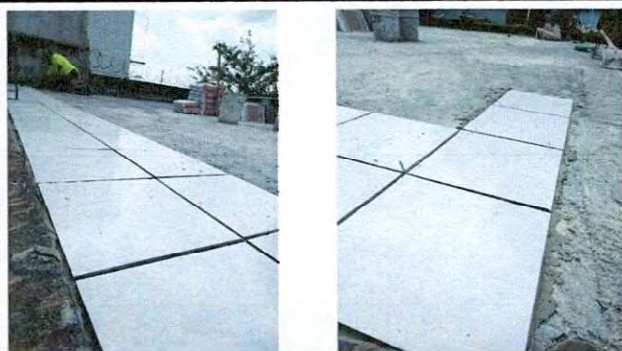
Foto 3: Impermeabilización de losa, deteriorada por la lluvia, ranuras de filtración de agua que ocasionan moho y salitre en las paredes de la cocina
