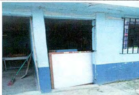
Foto 5: Sustitución de puerta y marco de puerta de bodega, deteriorada del marco, oxidada y carcomida de la parte de abajo, topa en el piso al abrir o cerrar
