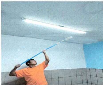
Foto 1: Saneamiento de cocina por salitre, en las paredes, por filtración de agua, de la terraza
