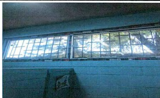
Foto 6: Sustitución de ventana interior del servicio sanitario de varones, marco dañado, vidrios no abren, marco vencido
