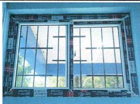
Foto 2: Sustitución de ventana y balcón en oficina de Dirección, marco de ventana quebrado, vidrios no se pueden abrir por el oxido del metal
