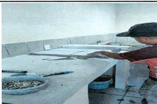
Foto 3: Cambio de azulejo y reforzamiento de mesa, por deterioro del azulejo, vencimiento de la mesa, se le coloco un tubo para que no se cayera
