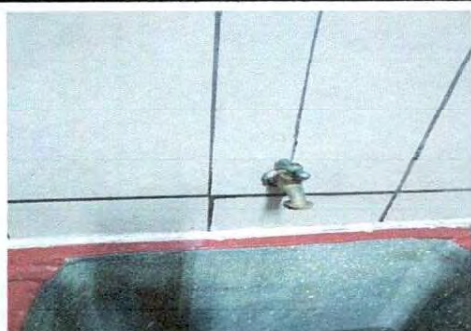
Foto 5: Sustrucción de chorro en pila de la cocina.
