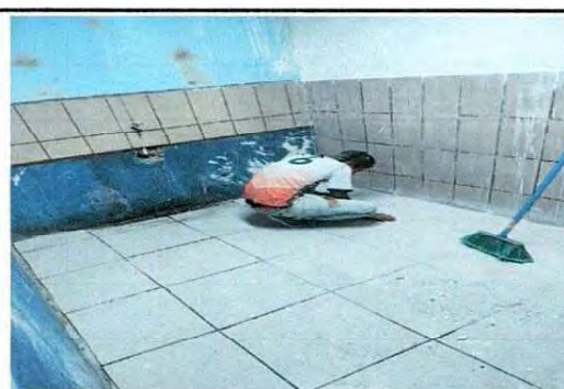
Foto 6: Sustitución de piso de la cocina, por deterioro se ha ido parchando con cuadros de otros colores
