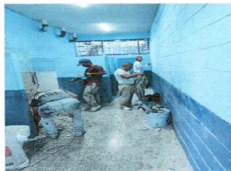
Foto 2: Sustrucción de azulejo, pintura del interior del servicio sanitario de varones
