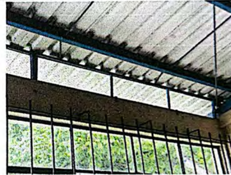
Foto 4: Marcos metálicos con cedazo para evitar el ingreso de aves a los salones de clases.
