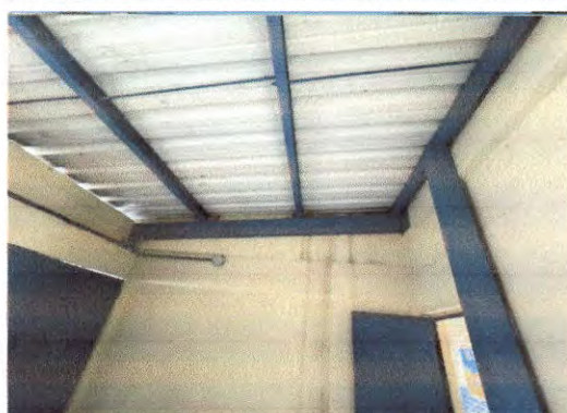
Foto 4: agua se filtra a los costados, es necesario colocar flashing
